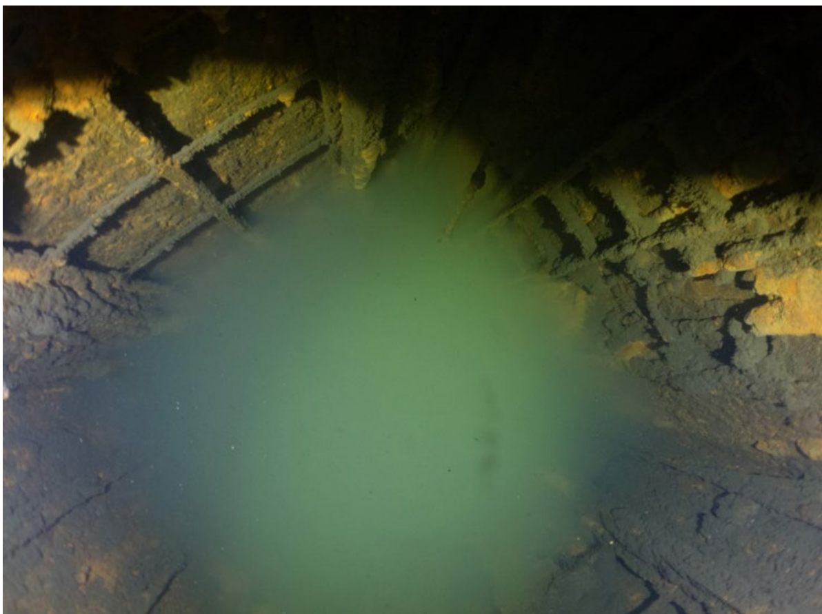
Zdjęcie 21. Wnętrze studni prowadzącej do centrali zaworowej rozdzielającej systemu rurociągów paliwa łączących poszczególne zbiorniki. Widoczny opalizujący płyn to najprawdopodobniej mieszanina wody i substancji ropopochodnych (źródło: ekspedycja 2018, fot. M. Czermiński)
