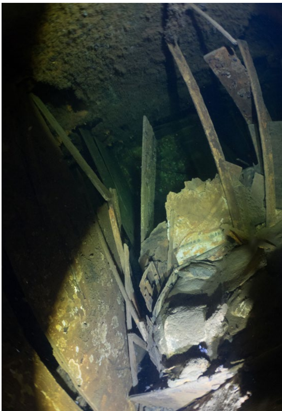
Zdjęcie 9. Zerwane wyposażenie i śmieci tarasujące wejście do pomieszczeń przepompowni (źródło: ekspedycja 2018, fot. M. Czermiński)
